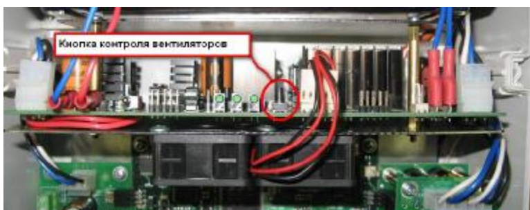
Рис. 2.11.5. Проверка работоспособности вентиляторов.
